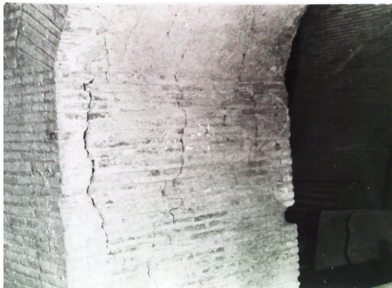
Fig.1. Lesioni da schiacciamento delle strutture verticali, ipogeo anfiteatro Flavio di Pozzuoli, Napoli - Archivio della Fondazione E.B. De Felice, faldone n. 174, foto n. 6684.
